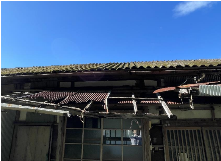
建物の一部に崩壊がある。
