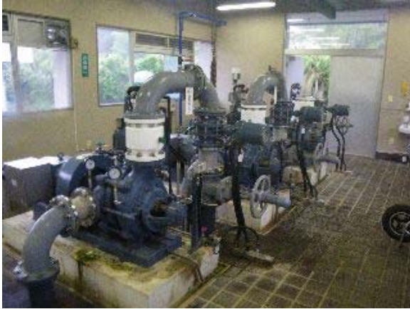
写真 2-5 便ノ山浄水場送水ポンプ
