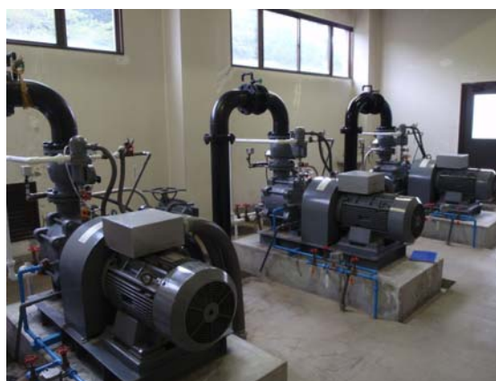
写真 4-2 紅ヶ平浄水場送水ポンプ
