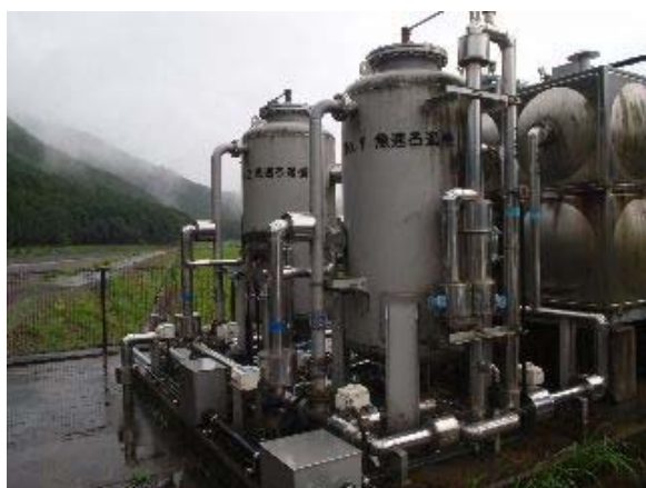
写真 2-3 十須浄水場(急速ろ過機)
