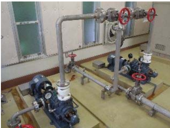
写真 2-7 下河内加圧ポンプ場
