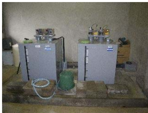
写真 2-4 紅ヶ平浄水場(塩素注入機)
