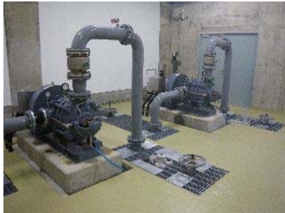
写真 2-6 馬瀬浄水場送水ポンプ
